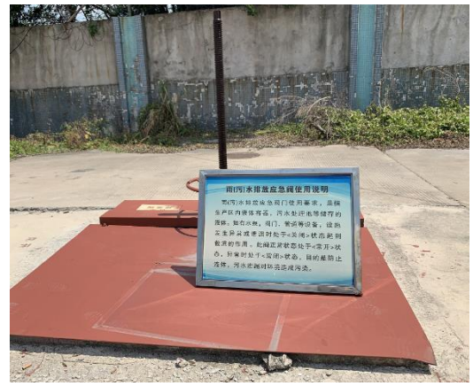
厂区雨水闸门
