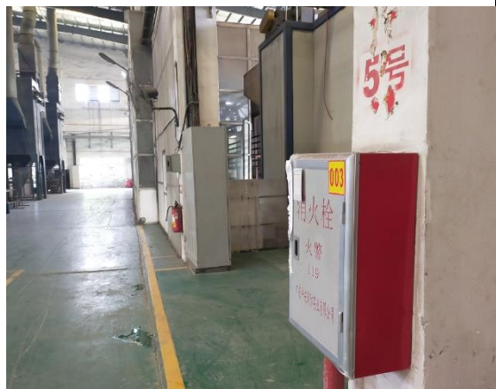
厂区消防设备
