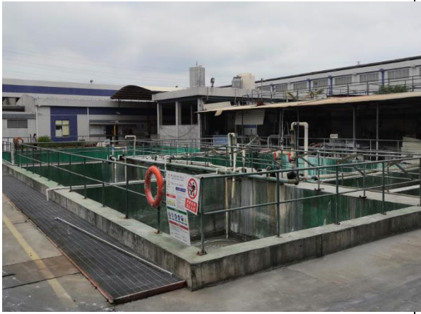
厂区污水处理站
